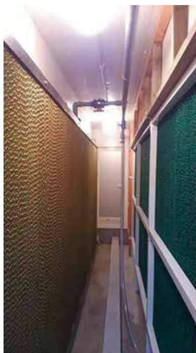
写真1 2層の脱臭バイオフィルター
